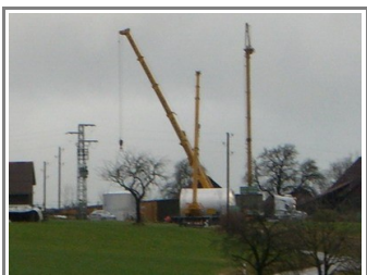
Der neue Hochbehälter in Arlesried.
